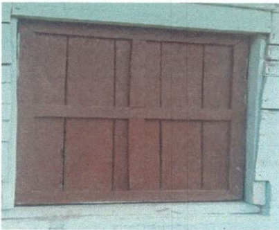
Foto 3: Daño de ventana
