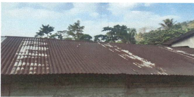
Foto 5: daño en lámina
