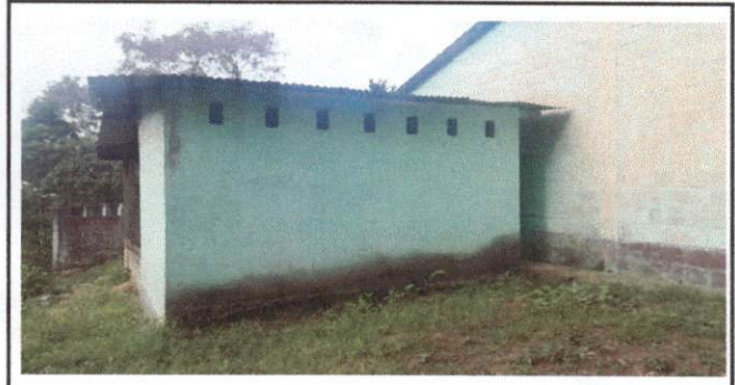
Foto 8: falta de ventana
