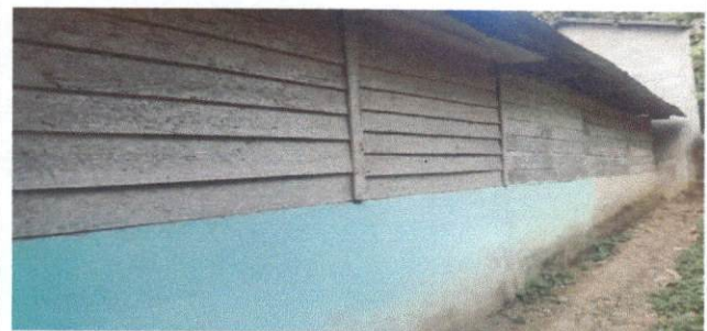
Foto 6: falta de balcon
