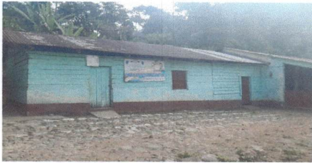
Foto 1: Daño en la pared del aula.
